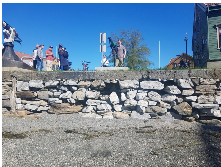
16. Tørrmur/støttemur i fjæraområdet ved tollboden (oppført i 1839-40) er i ferd med å rase ut. Tollbodbygningen skimtes til høyre i bildet. Foto: Keth Lind, UM
