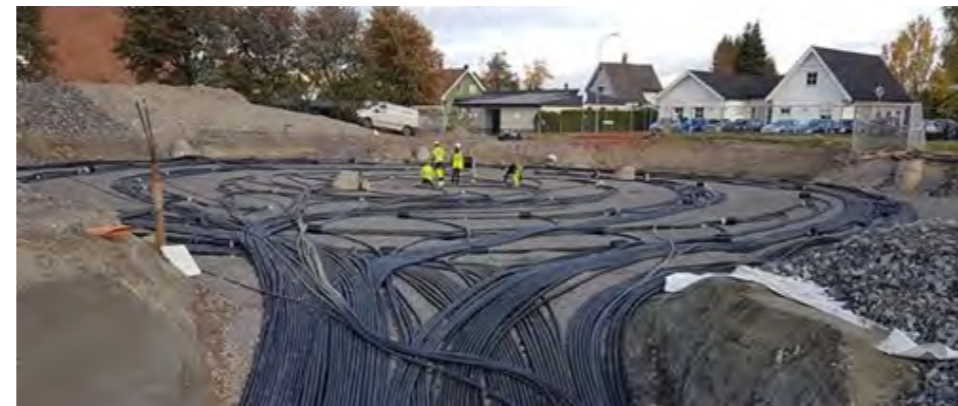
GeoTermos ved Fjell skole i Drammen med seriekoblede brønner
