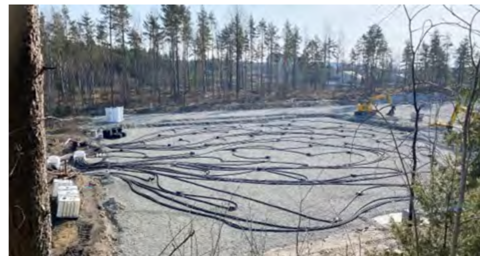
Solfangere og varmerør, kunstgressbane sør for Oslo
