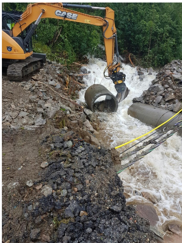
Figur 10 Vi må sørge for at stikkrenner og vannveger er dimensjonert i forhold til framtidige nedbørsmengder. Styrt regn resulterte her flom i en bekk med ødeleggelse av veg, stikkrenne og autovern i Målselv fjellandsby.
