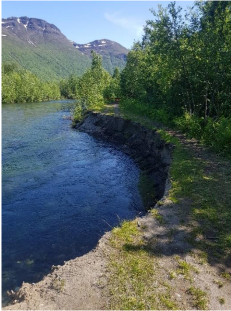
Figur 12: Deler av turstien på sørsiden av Nordkjoselva som er erodert.
